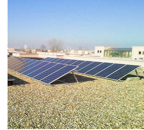
Resim 26 .Çatıda Güneş Paneli Kullanımı
